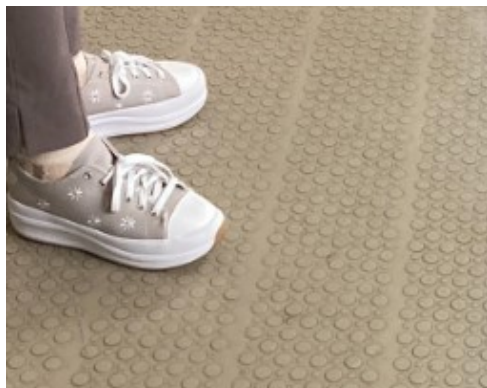
滑り防止の凹凸廊下。 デコボコがあって雨水が拭き取れず滑る。
